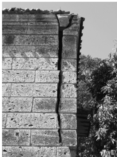
写真 4. 益子参考館 2号館に入った亀裂 (筆者撮影)
