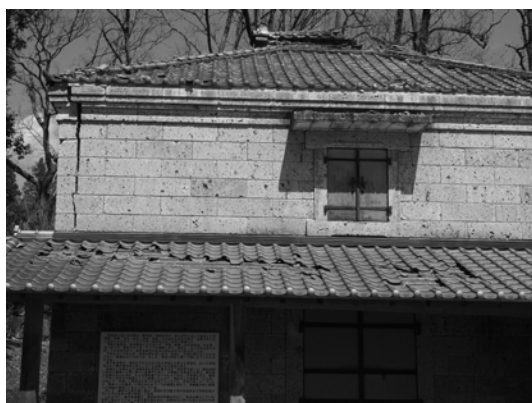
写真 3. 被災した益子参考館 3号館 (筆者撮影)
