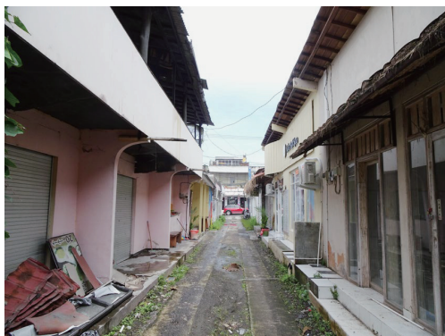
写真4-8 閉鎖し荒れた状態の店舗跡
